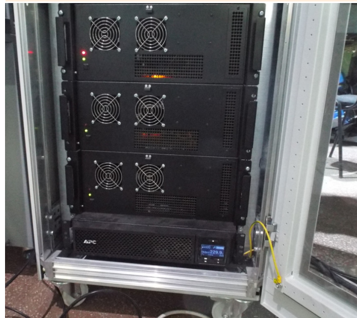
Компьютеры и источник бесперебойного питания в серверном шкафу
